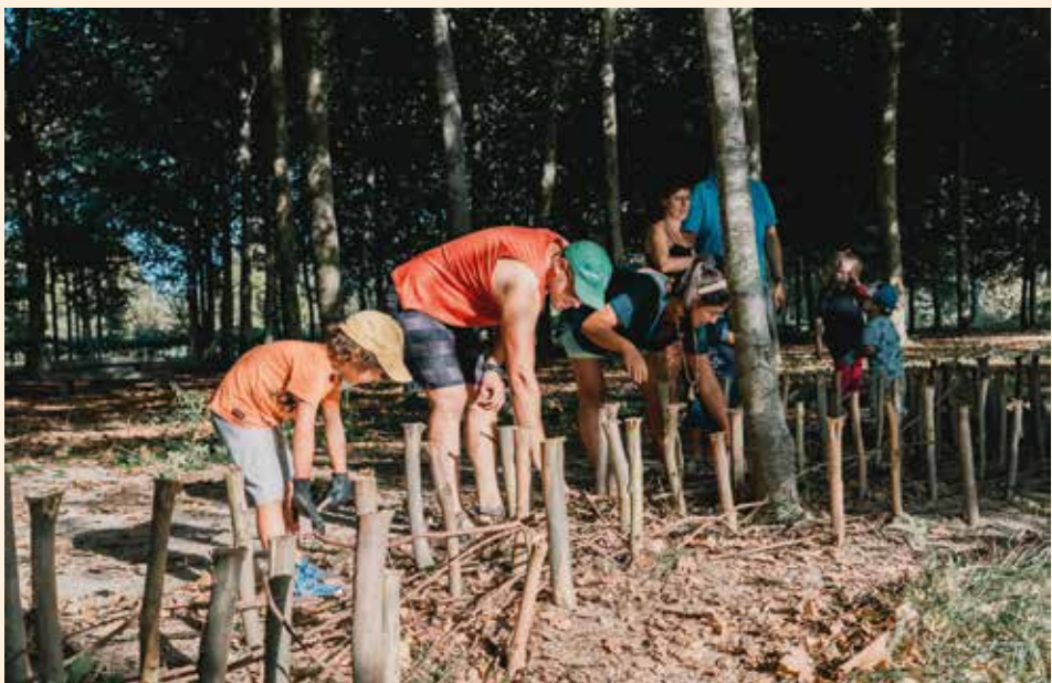
FIGURA 42 Estrutura de ecodesign construída com voluntários ao abrigo do projeto EcoRagri4Hidro (©Jorge Barbosa).
